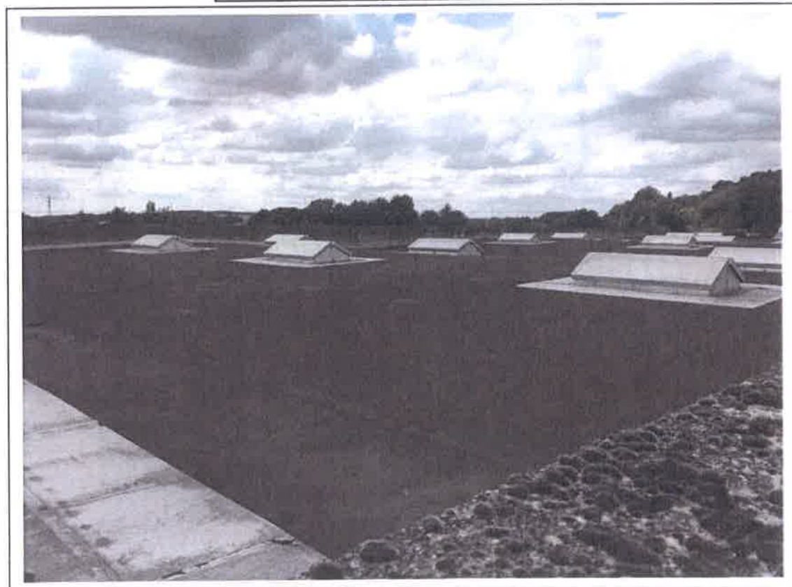
Couverture + exutoire de désenfumage
