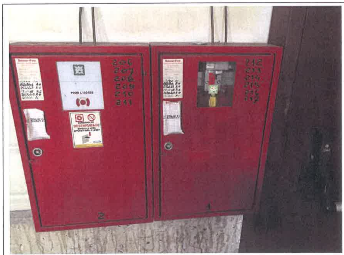
Commandes manuelles de type APS disposée à proximité de l'accès en façade – commande d'ouverture de 6 exutoires
